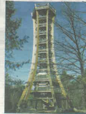
Der Aussichtsturm am Felixsee wird 2018 komplett saniert. Dabei verliert er auch sein heutiges Aussehen. Foto: Schmidtchen
